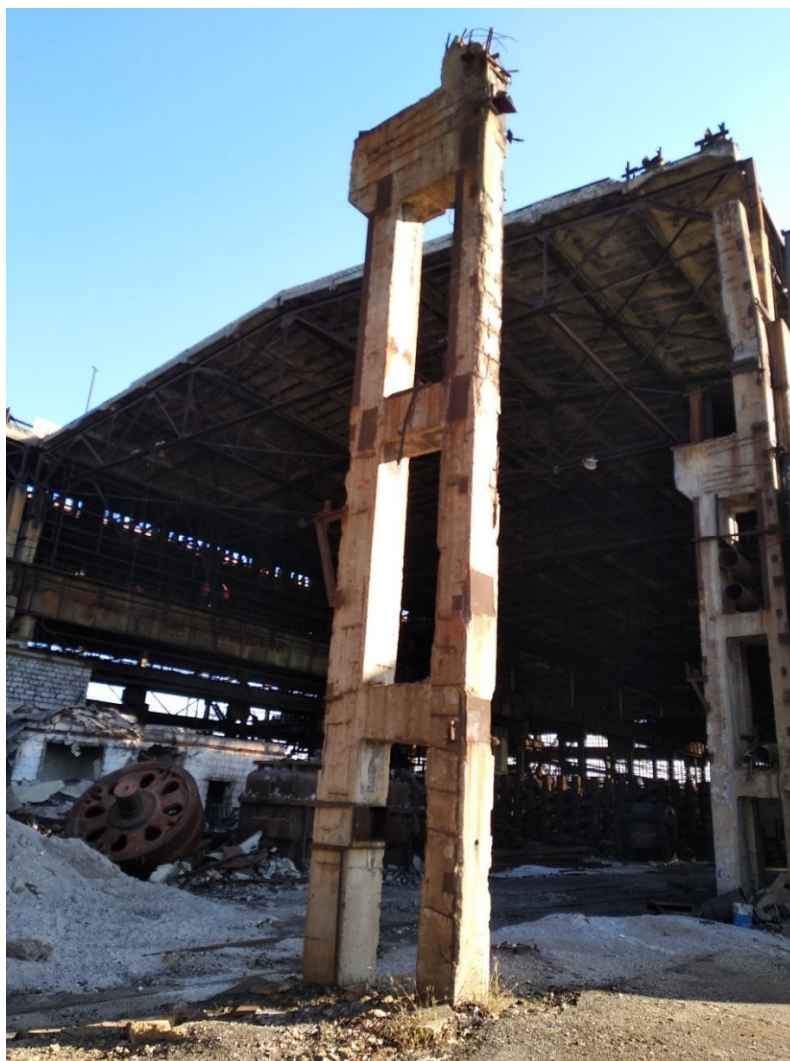
Рисунок 1 — Участок обрушившихся конструкций в осях «213–217»
